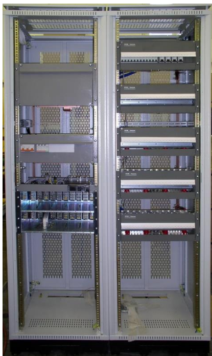
Модульная ЭПУ серии ЭС-48/750-42U , слева базовый системный центр без нагрузочных модулей распределения, справа дополнительный шкаф с 5-ю модулями ВРМ-24 (двери и заглушки сняты)
