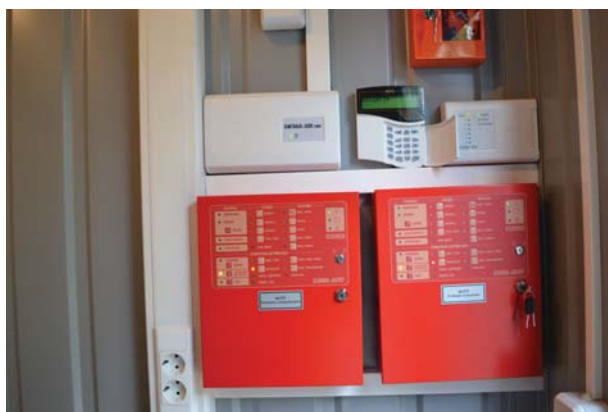
Системы безопасности и пожаротушения
