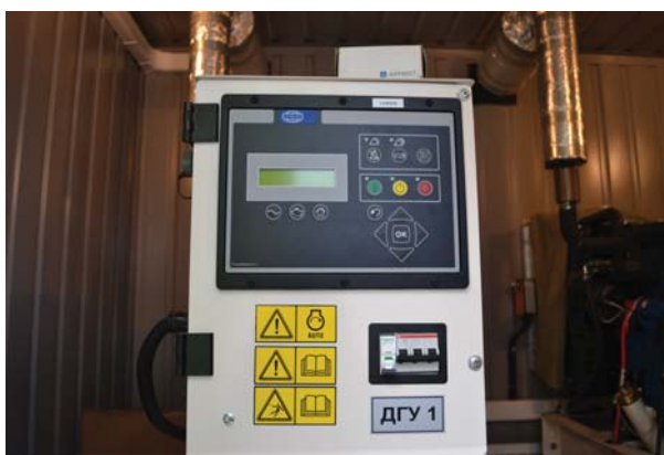
Панель управления дизельной электростанцией
