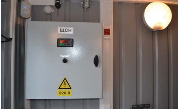
Щит собственных нужд
