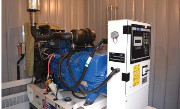
Две дизельные электростанции
